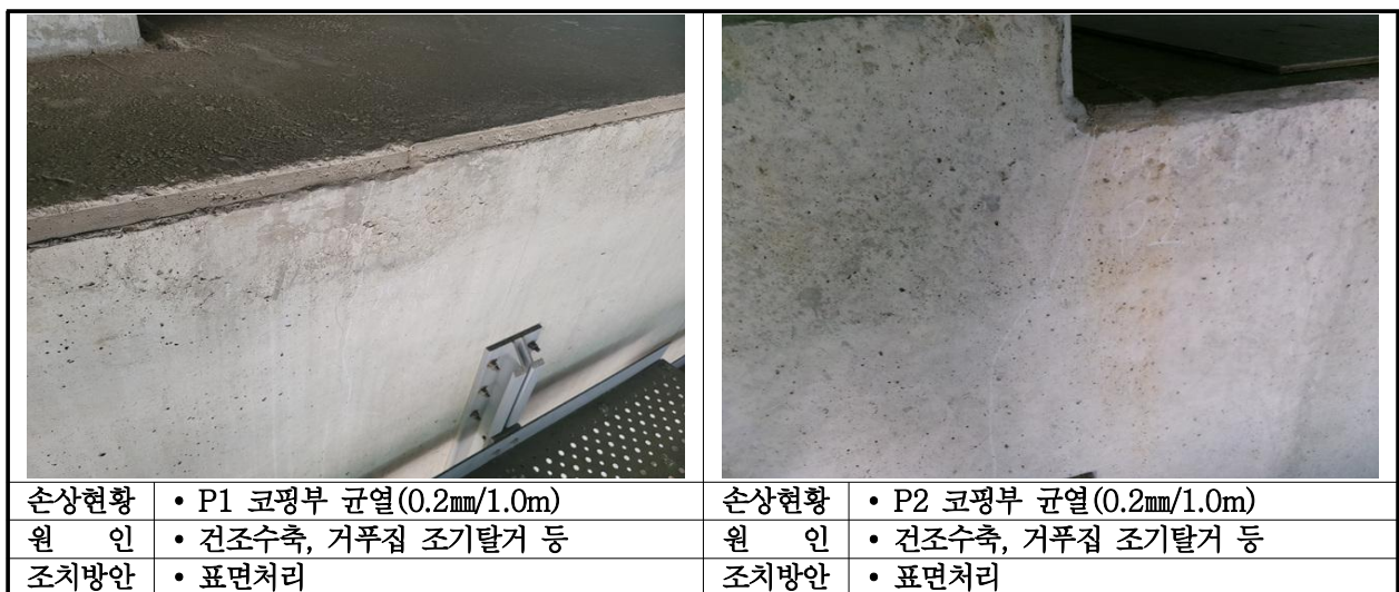
【사진 1.3.11】 교각 손상현황
